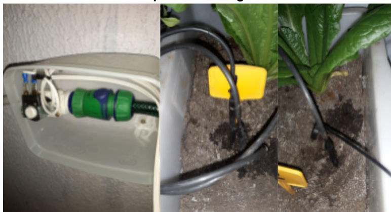
Figura 05 - Válvula solenóide a esquerda e mangueiras instaladas na horta a direita
