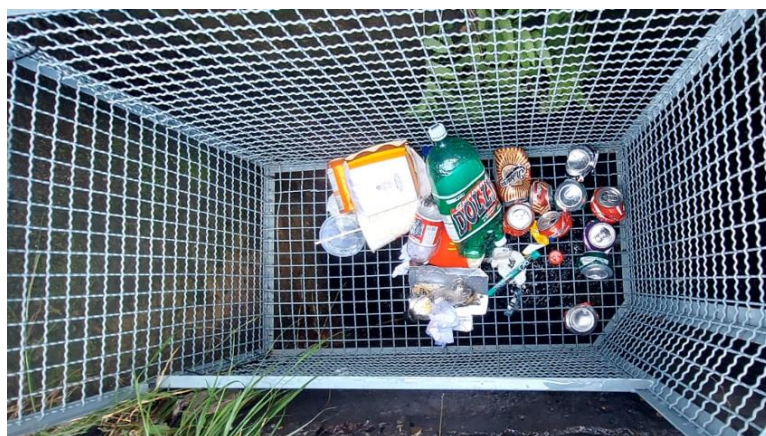
Figura 3. Vista parcial da lixeira instalada no bueiro.
