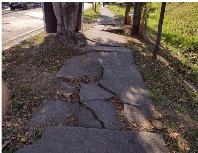
Imagem 6. Área de lazer com o piso danificado.
