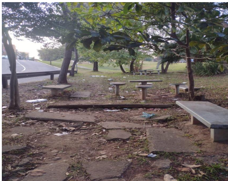
Imagem 5. Área de lazer com o piso danificado.
